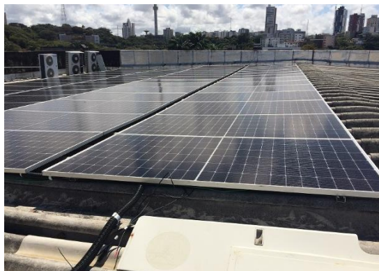
Placas fotovoltaicas instaladas no PAF V
