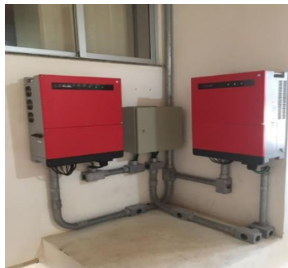
Inversores fotovoltaicos do PAF V
